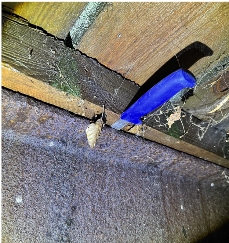
Bild 10, information – Saknar papp eller åldersbeständigt gummi mellan stål balkar och trä
