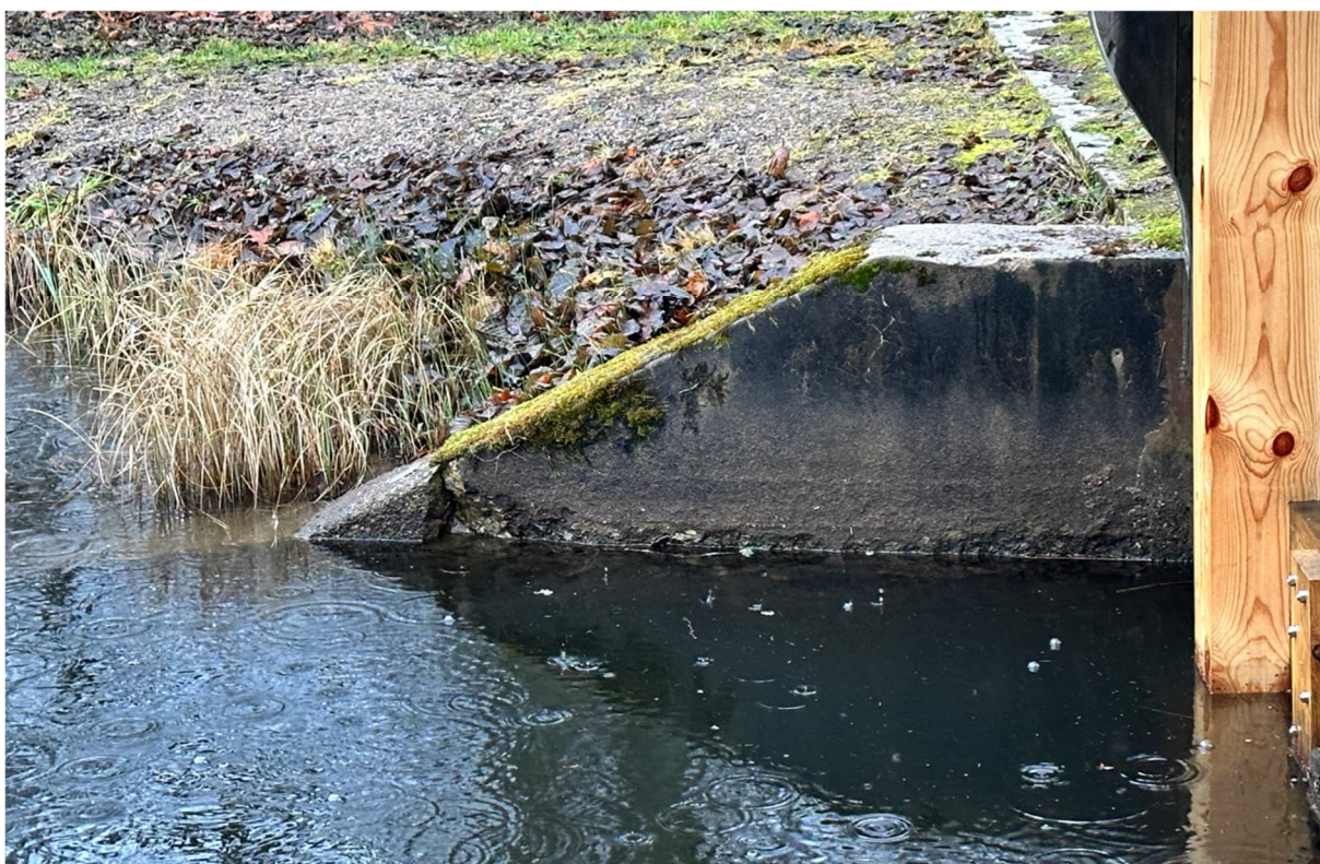
Bild 12 skada nr 8 – Betongskador på uppströms vänster ledmur
