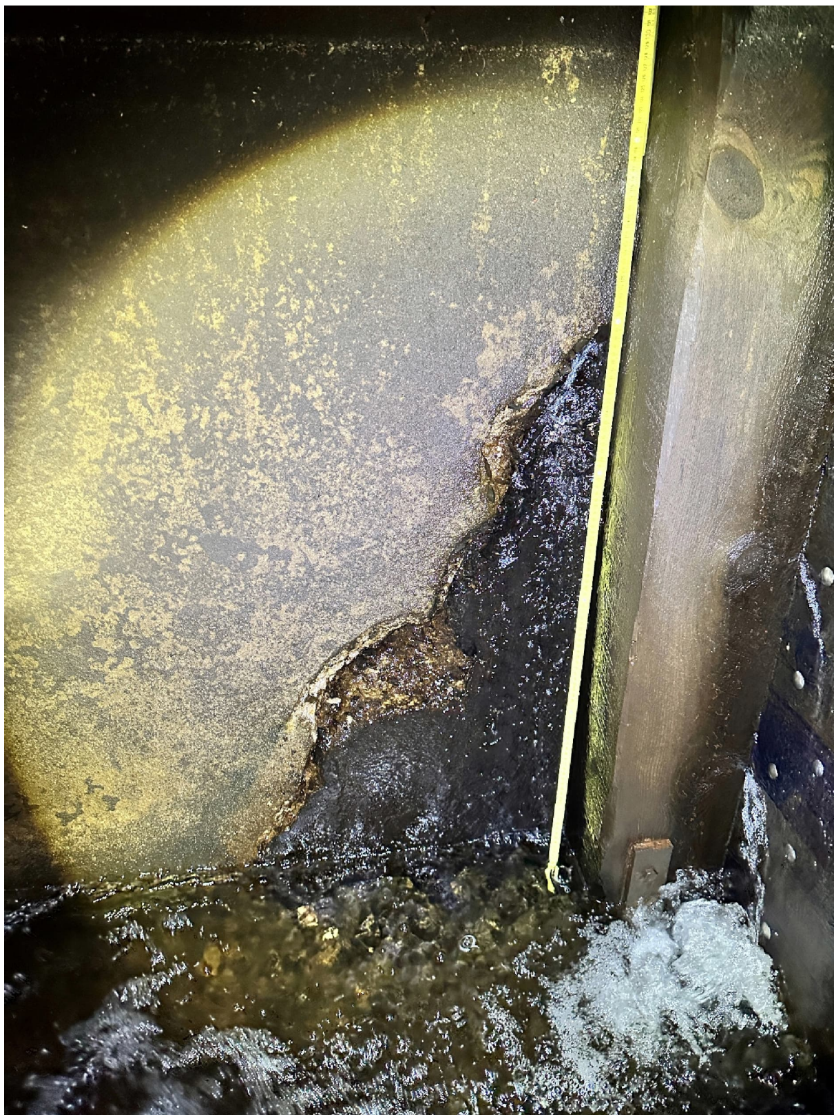
Bild 13 skada nr 9 – Inläckage mellan dammluckor och östra frontmur och ledmur/vingmur
