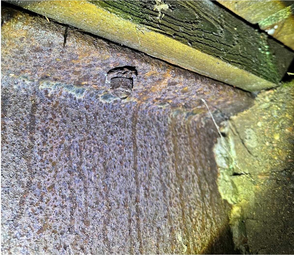
Bild 16 Skada nr 12 - korrosion skruv
