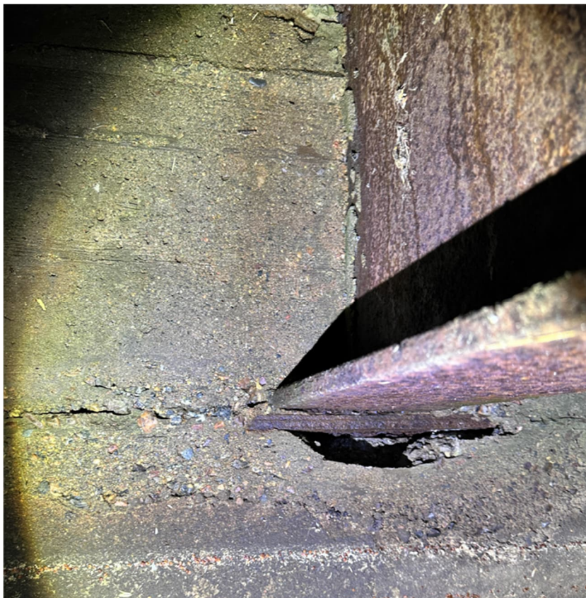
Bild 7, skada nr 5 – Närmare vy
