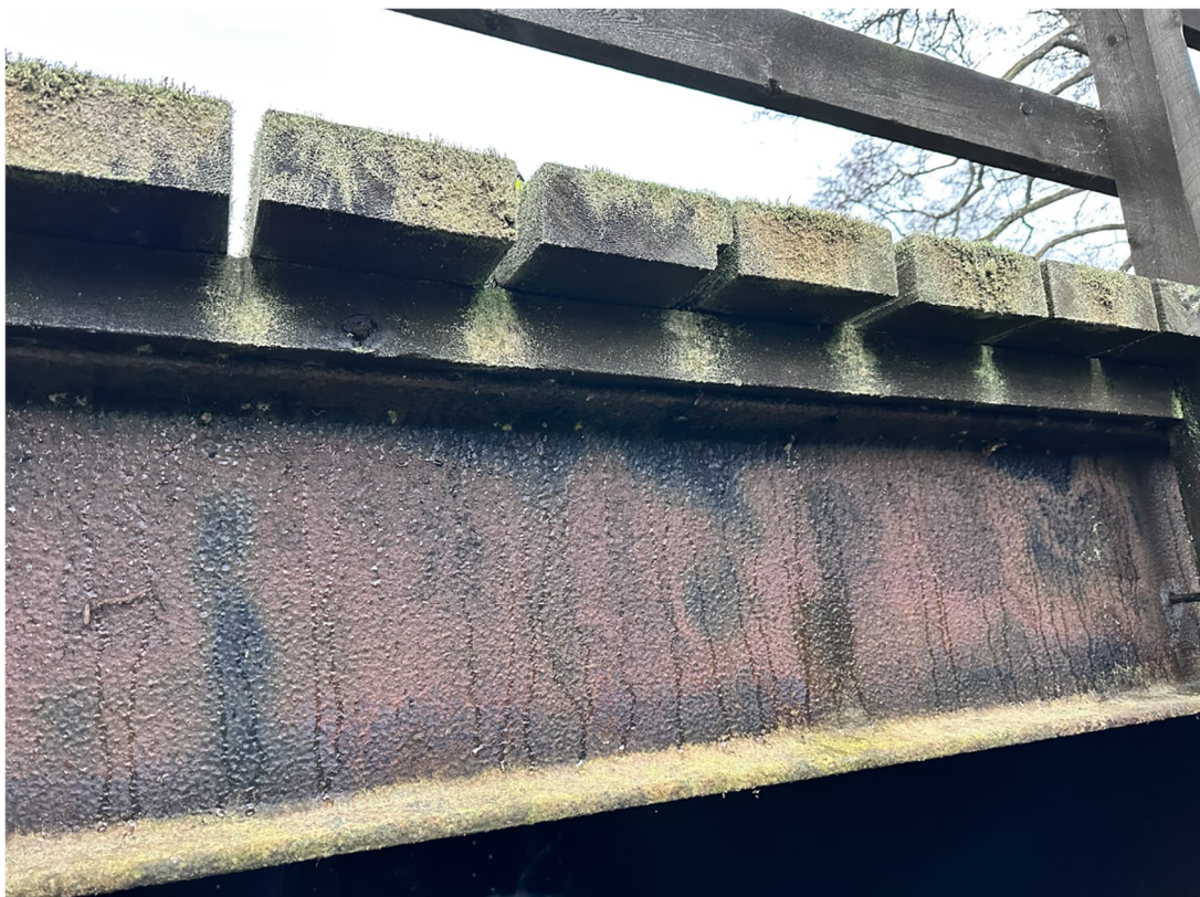
Bild 1, skada nr 1 och 2 – Huvudbalkar korrosion, likartat över alla huvudbalkar
