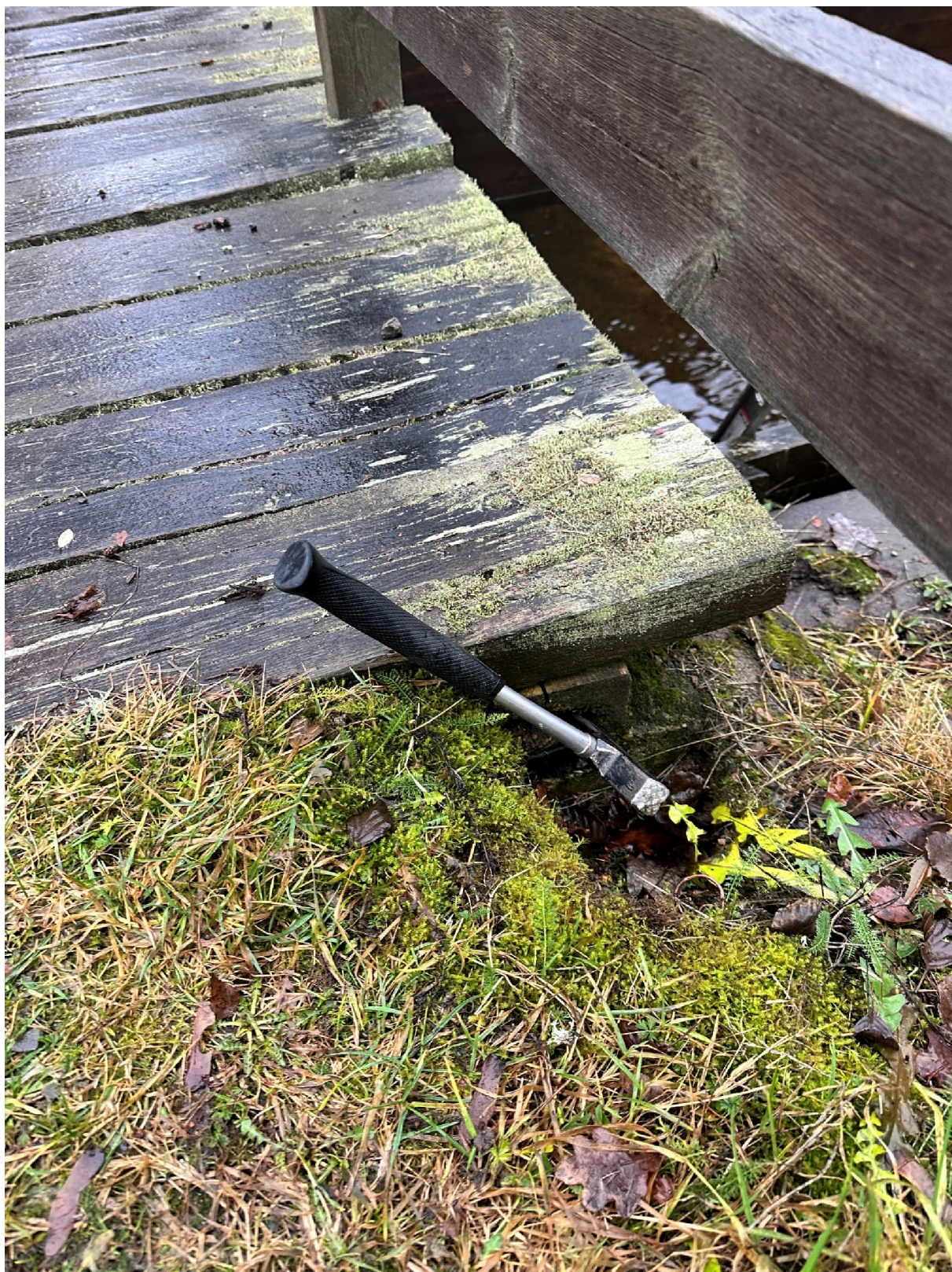
Bild 14 Skada nr 10 - röta i träsyll
