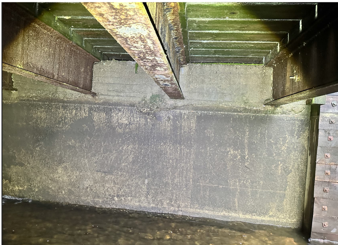
Bild 2, skada nr 1 och 2 – Översikt av övriga huvudbalkar
