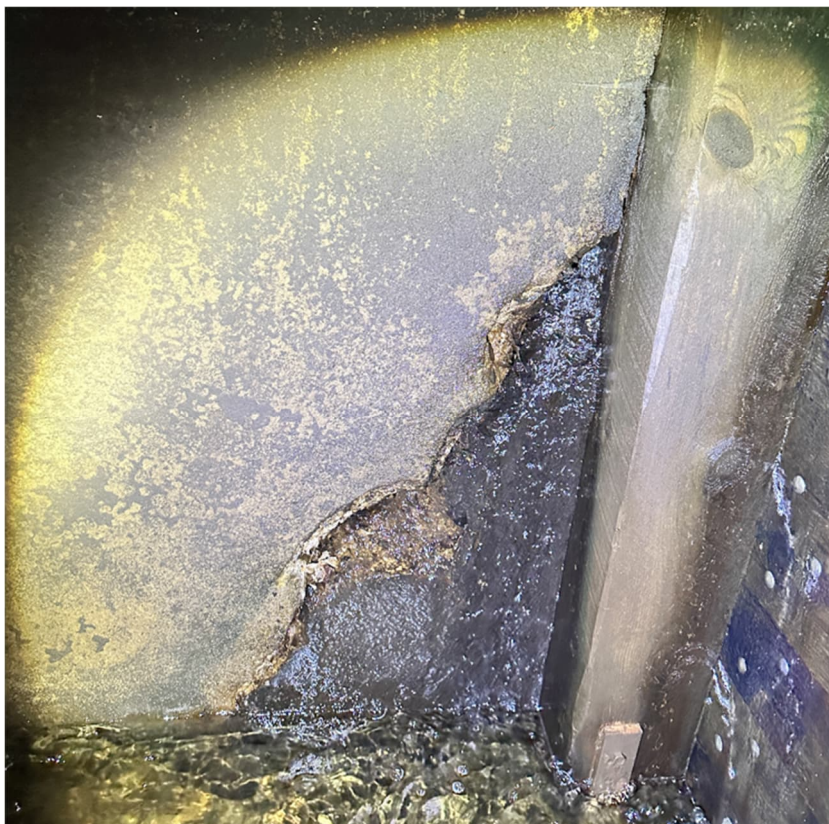
Bild 8, skada nr 6 – Vittringsskada som spjälkat i östra frontmur närmast luckorna
