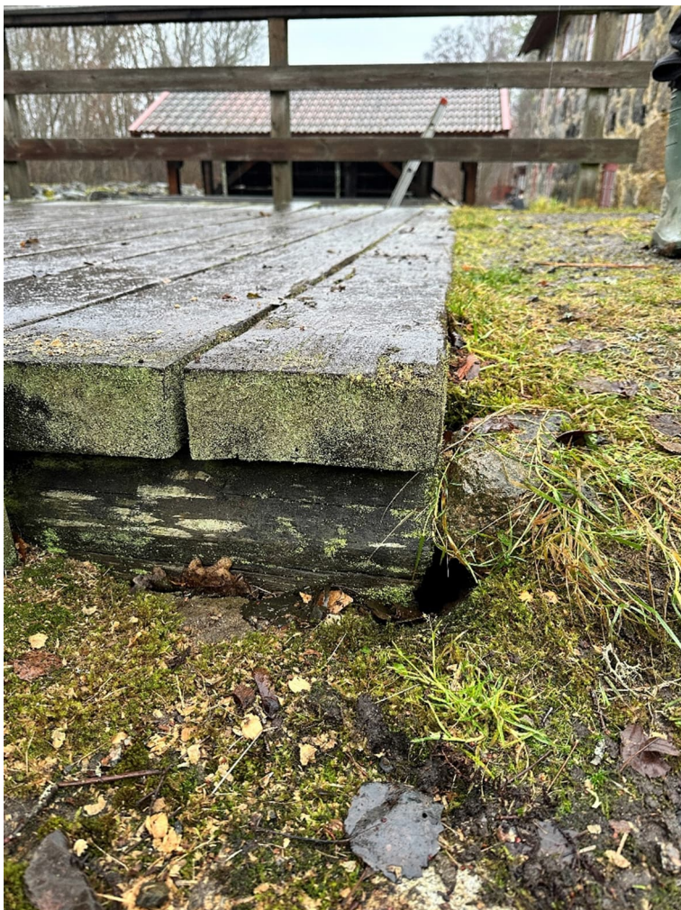
Bild 5, skada nr 4 – Röta i träbalken ovanpå södra huvudbalk
