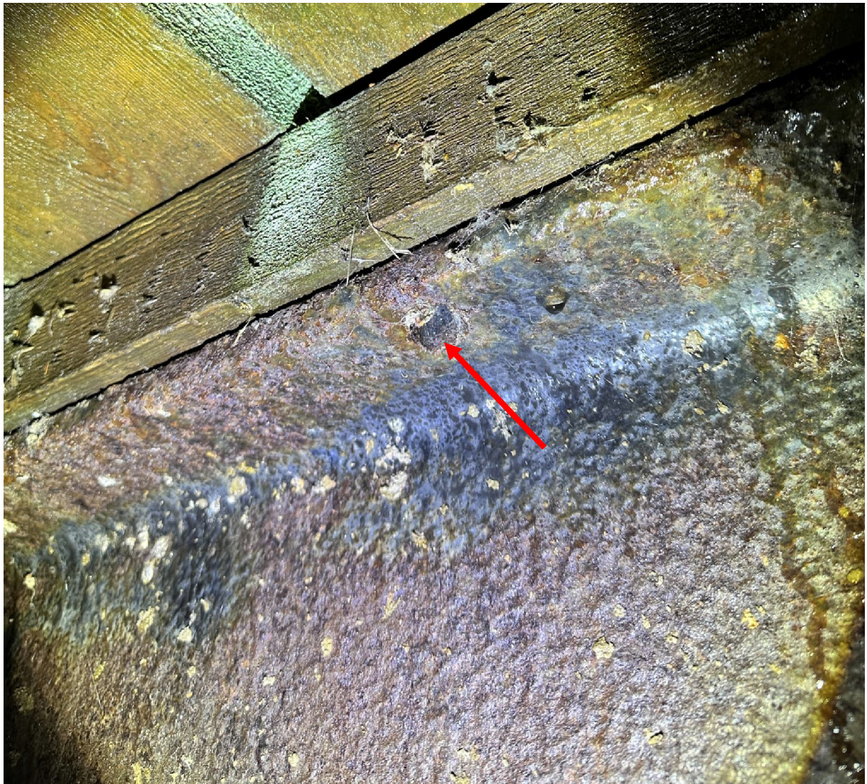
Bild 15 Skada 11 - skruv saknas
