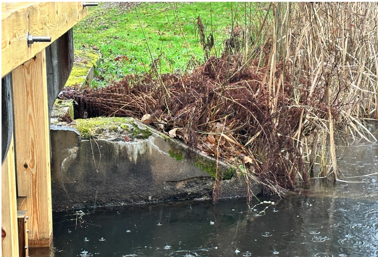
Bild 11, skada nr 7 – Betongskador på uppströms höger ledmur
