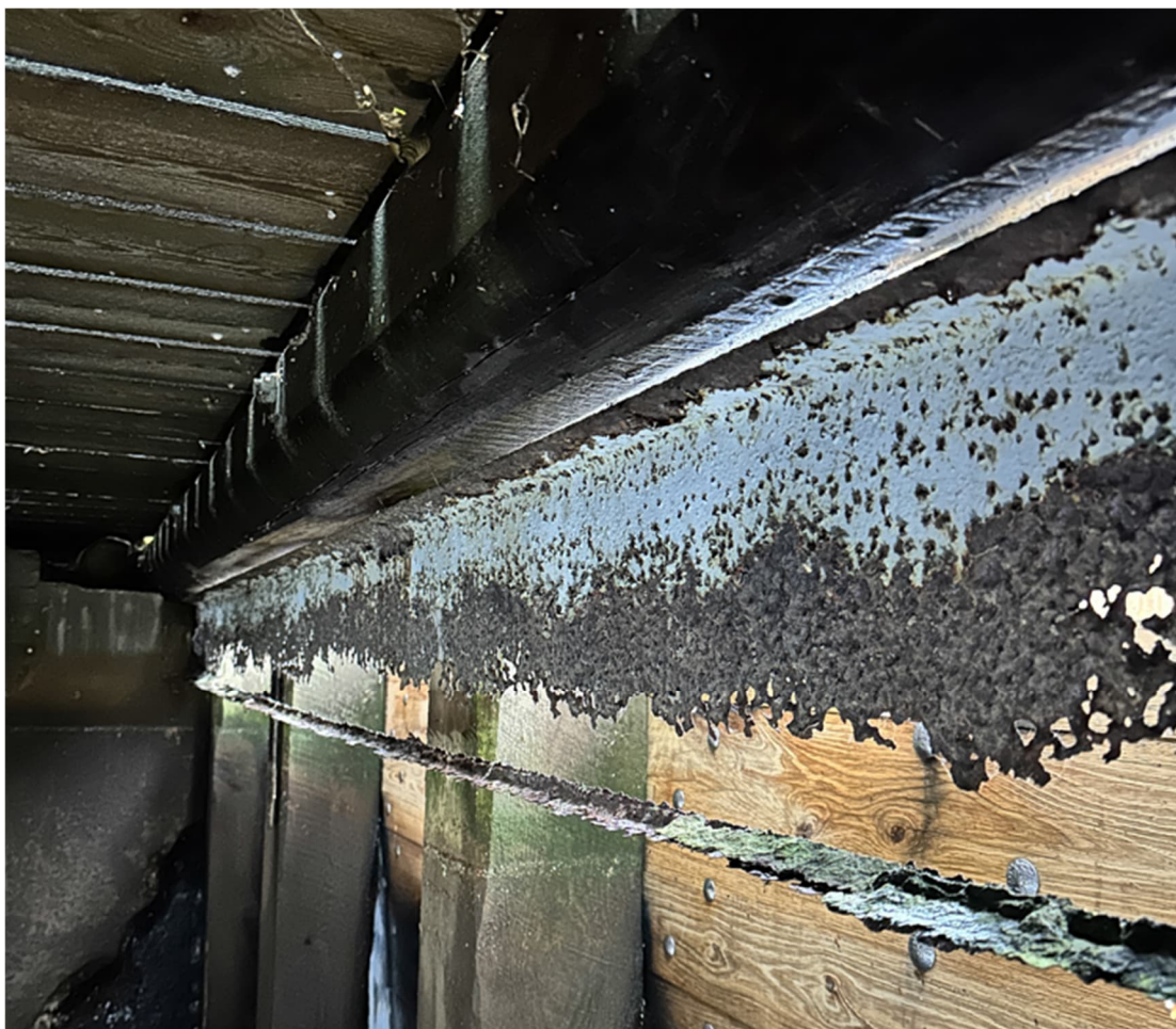
Bild 3, skada nr 3 och 4 – Södra huvudbalk, sönderrostad, samt träbalken ovanpå huvudbalken
