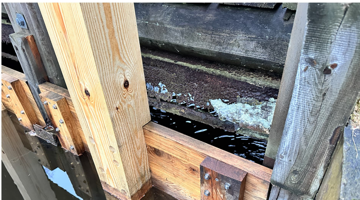
Bild 4, skada nr 3 och 4 – Södra huvudbalk, sönderrostad, samt träbalken ovanpå huvudbalken
