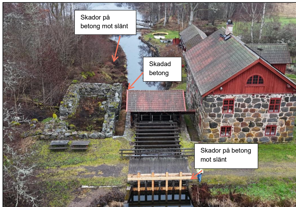
Figur 10. Observerade skador vid kvarnbyggnaden och kvarnmiljöns ledmurar mot utloppet i Övrasjö. Källa: (Tyréns Sverige AB (a), 2025)
