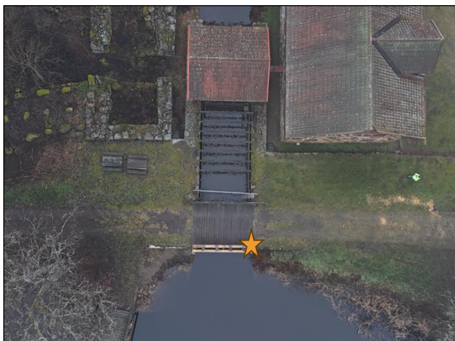
Figur 9. Foto på bron sedd uppifrån. Vid markerat läge av utskovet/bron har spjälkningsskador observerats. Källa: (Tyréns Sverige AB (a), 2025)
