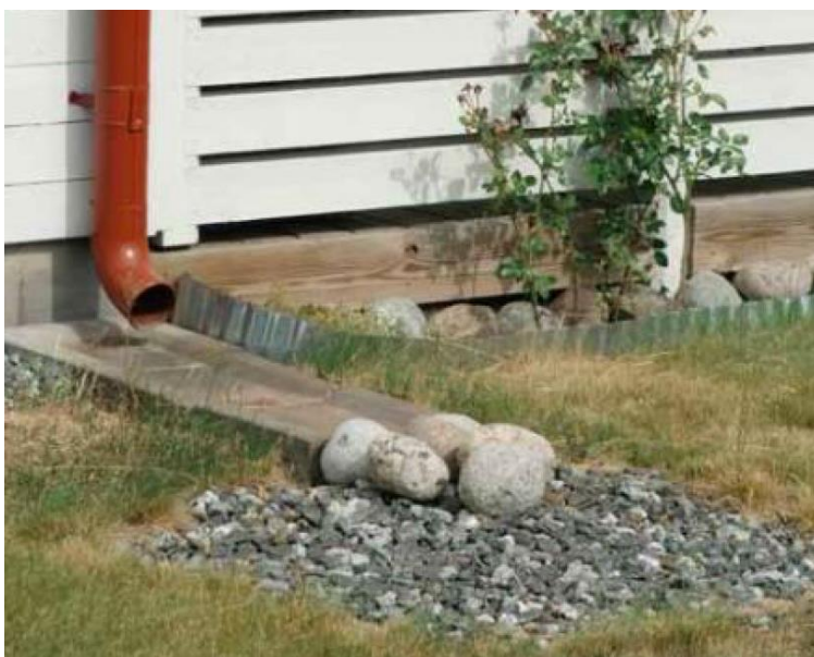
Figur 10: Stuprörutkastare med rännalsplattor och erosionsskydd som leder ut vattnet på gräsmattan. Foto: Dagvattenhandbok, Haninge kommun 2019.
